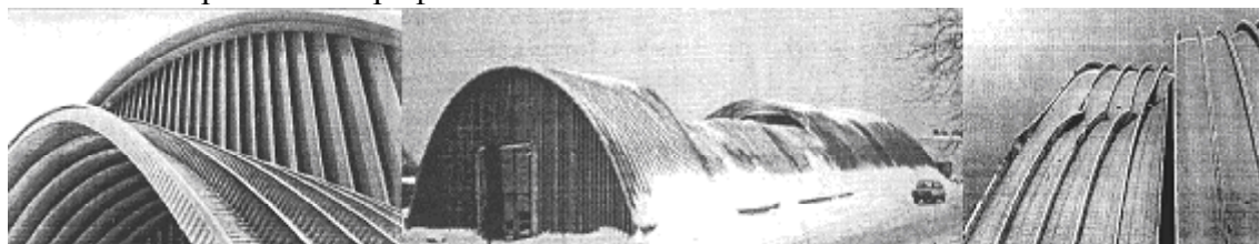
Рис. 3, 4 и 5: фрагмент фасада бескаркасного здания из холодногнутых профилей; разрушенное арочное покрытие пролетом 20,5 м; местная потеря устойчивости профилей оболочки под действием сосредоточенной силы
