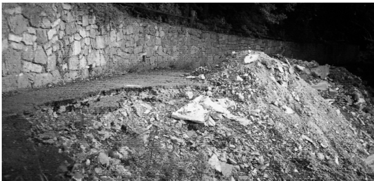
Рис. 2. Разрушение дороги в головной части «Восточного» оползня.
