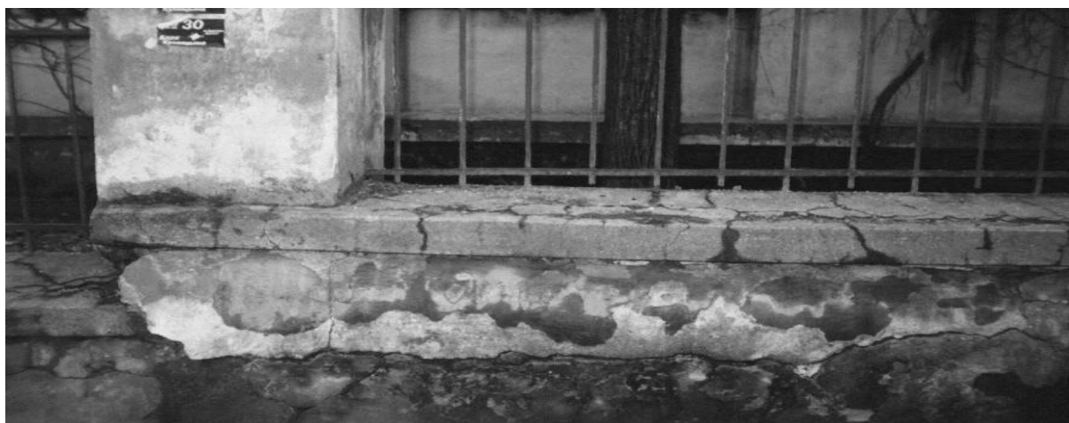
рис. 2. Выпор грунтов-оснований в каменном заборе
