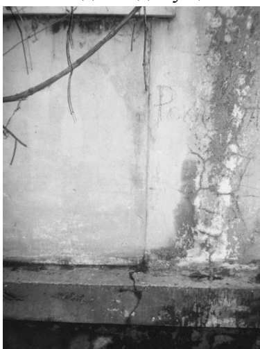
рис. 5. Ветвящаяся трещина вдоль стены
