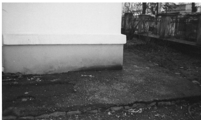
рис. 4. Размытая отмостка и угол здания, отделившийся от отмостки
