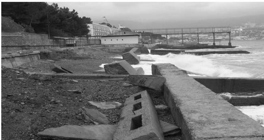
Рис. 4. Разрушенный экстремальными штормами пляж «Солнечный» в г. Ялта.
