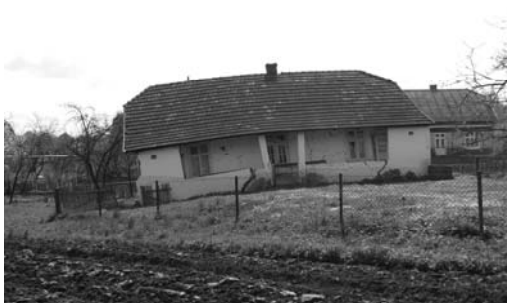
Рисунок 3. Порушення будинку в зоні впливу лінійної просадки. Стебник
