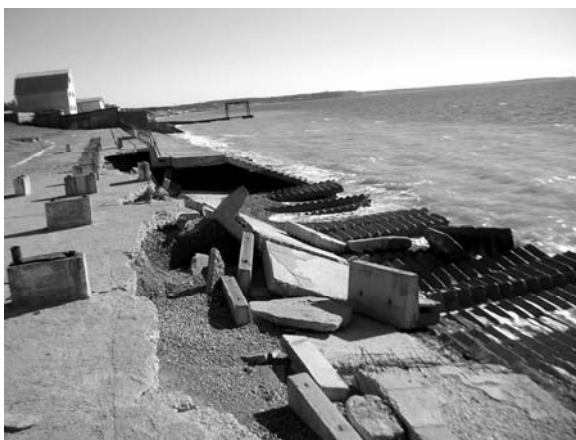
Рис. 4. Разрушения берега у санатория «Радуга»
