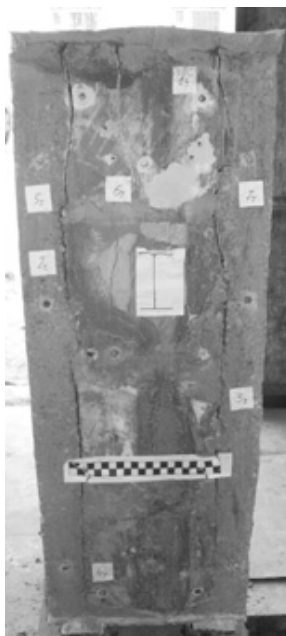
Рис.2. Трещины по двум сторонам обоймы простенка серии КО
