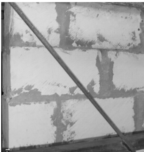
Рис.1 Волосяные продольные трещины по телу кладки серии К
