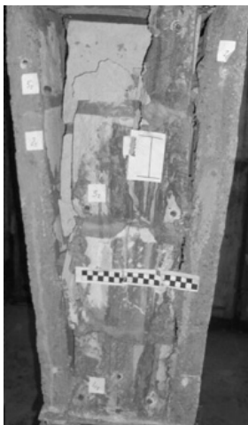
Рис.4. Трещины по двум сторонам обоймы простенка серии КОХ с хомутами ВРІ
