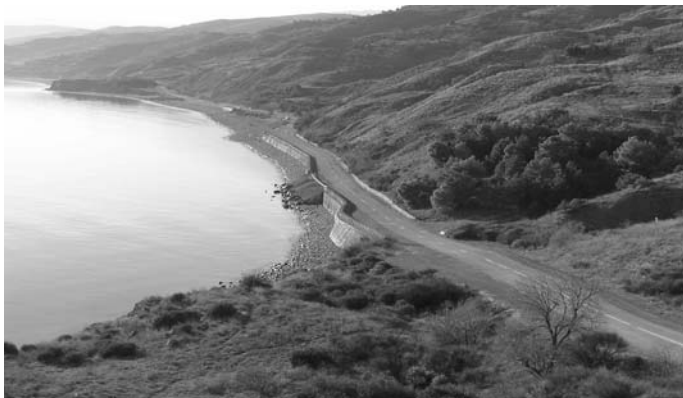
Рис. 5. Размыв автодороги Алушта - Феодосия в районе пгт. Морское.
