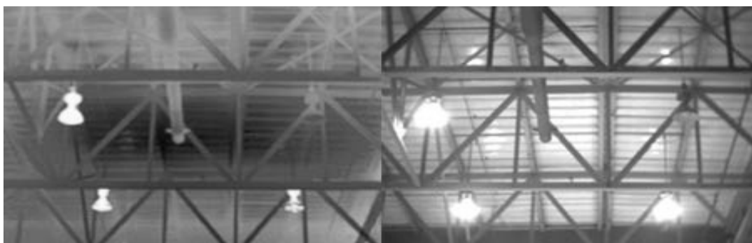
Рис.4 Осмотр внутренней поверхности крыши, насыщенной влагой
