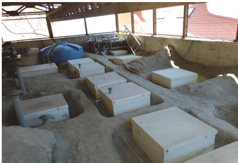
Рисунок 1 – Очистные сооружения на базе отдыха с. Малый Маяк: а) общий вид малых очистных сооружений; б) способ использования очищенной сточной воды.
