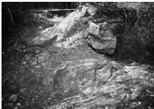
Рис. 13. Разрушение дороги левым бортом «Западного» оползня.
