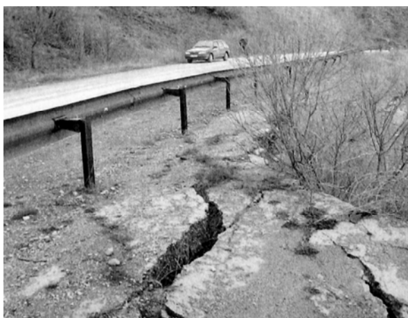
Рис. 3. Заколы вблизи автодороги Алушта – Феодосия, пгт. Рыбачье.
