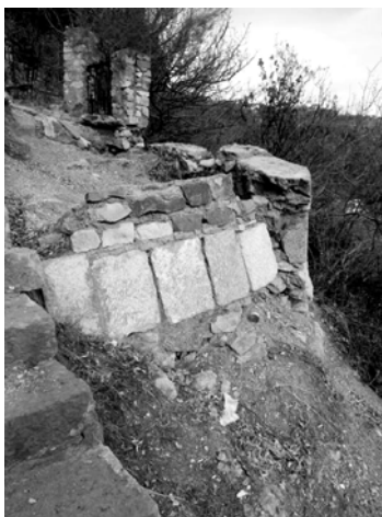
Рис. 14. Разрушение подпорных стен вдоль дороги от Воронцовского дворца к морю.
