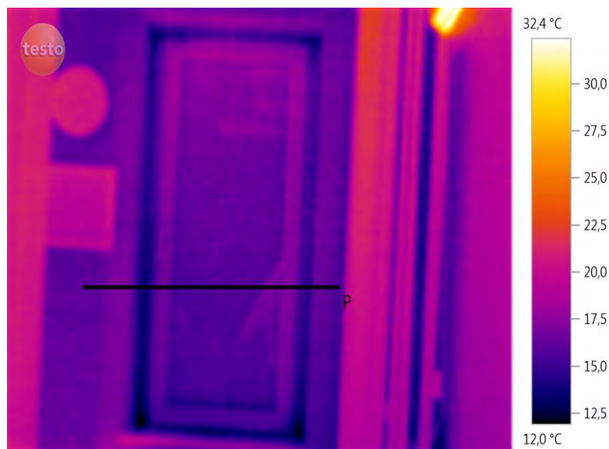
Рис.1. Снимок светопрозрачного проема с установленной панелью
