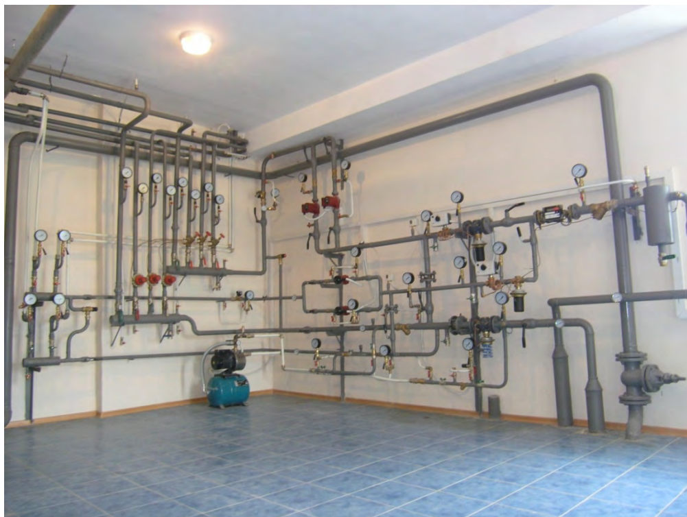
Тепловой пункт, используемый для лабораторных работ в учебном процессе.
