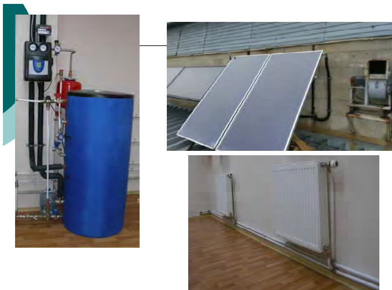
Бак-аккумулятор коллектор и фрагмент системы отопления после реконструкции
