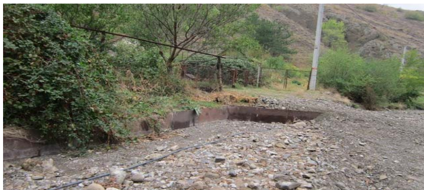
Рис. 3. Бассейн р. Ай-Серез в пределах с. Междуречье. Разрушение подпорной стенки, хозяйственных сооружений и накопление обломочного материала в русле реки (потенциальная твердая составляющая селей). Фото автора
