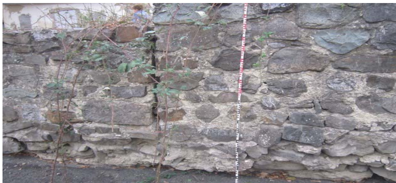
Рис. 2. Бассейн р. Ускут нарушенная паводком подпорная стенка в центре населенного пункта Приветное. На заднем плане видно разрушающееся строение. Фото автора
