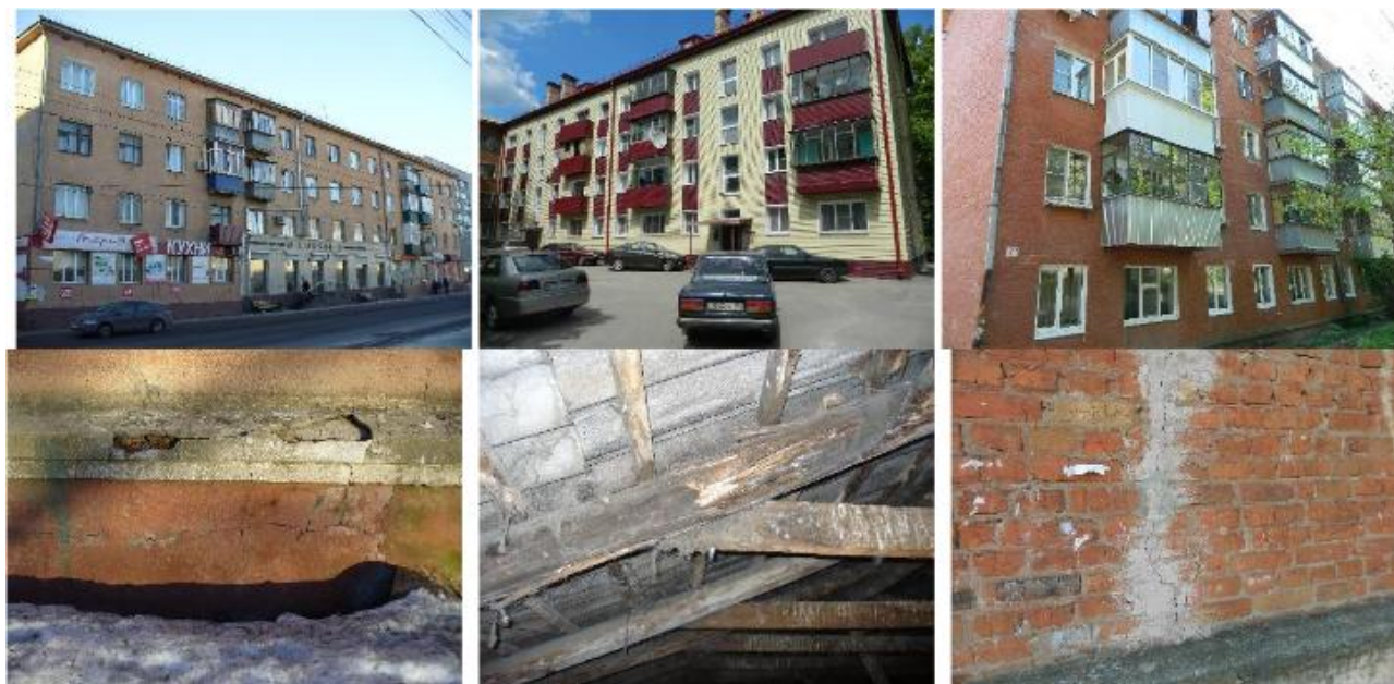
Рис. 1. Материалы фотофиксации объектов обследования и их дефектов
