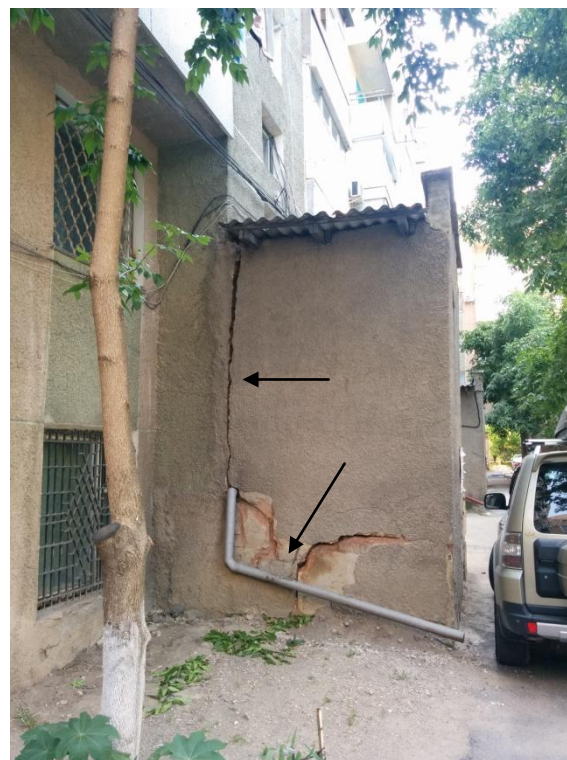
Рис. 5. Фрагмент фасада многоквартирного жилого дома. Неравномерная осадка конструкций подвезда
